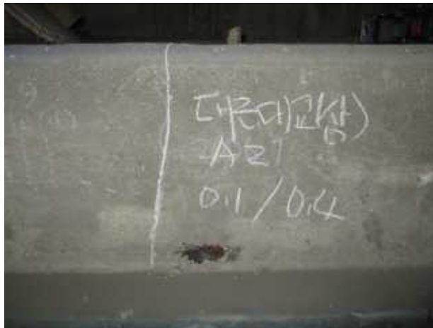
A2 교대 균열(0.3mm미만)
