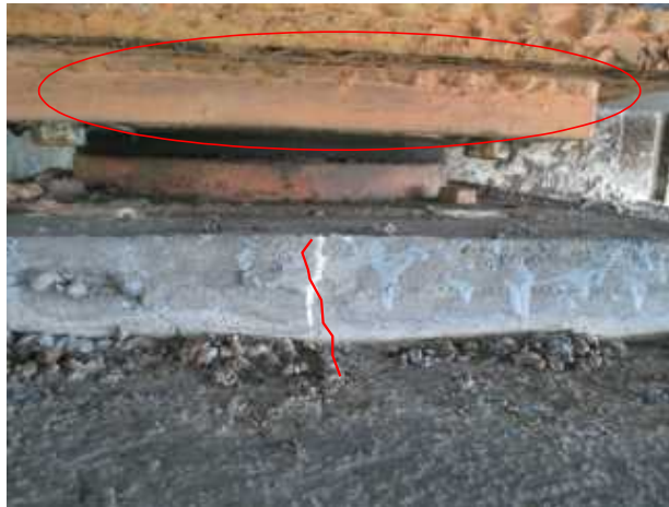
P1 Sh4 Plate 부식 및 받침 Con'C균열
