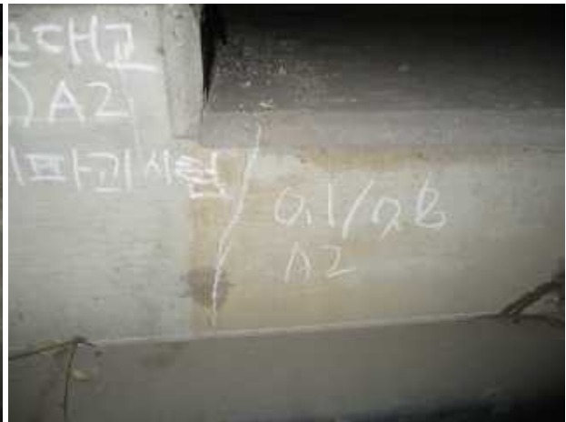
A2 교대 균열(0.3mm미만)
